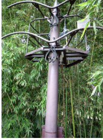
管理施設 大型照明柱 (後楽園)
