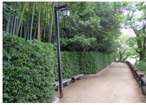
管理施設 照明柱 (後楽園)
