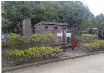
電気設備 (倉敷スポーツ公園)
