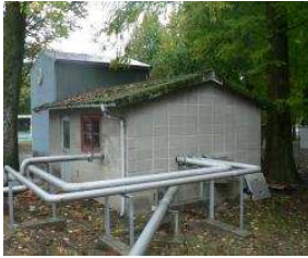
水泳場 ポンプ室 (総合グラウンド)
