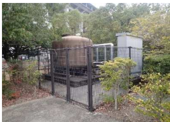
噴水設備 (倉敷スポーツ公園)
