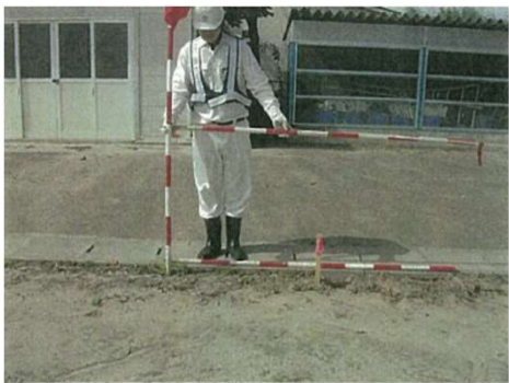
復旧延長写真 (起点)
