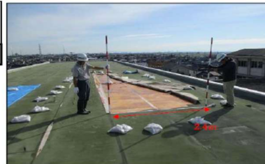
1-5 教室棟屋上 防水シート破損 ・ W=2.4m
