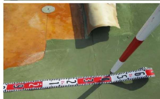
1-7 教室棟屋上 防水シート破損 ・ 終点 2.4m 確認 (W=2.4m)
