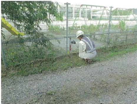
出水痕跡写真 (遠景)
