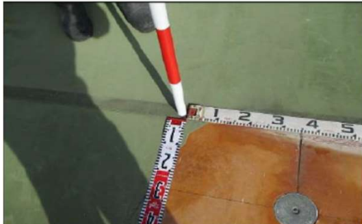
1-3 教室棟屋上 防水シート破損 ・ 始点 0m 確認 (L=10.8 m)
