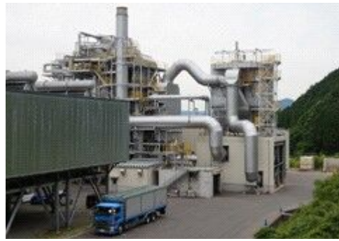
木質バイオマス発電所
