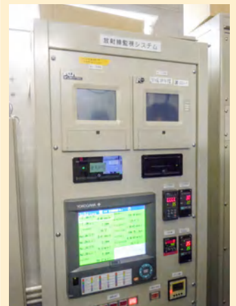
空間ガンマ線測定装置
