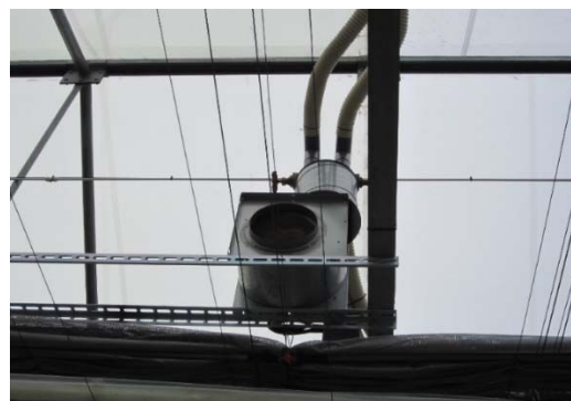
空気膜の加圧のための送風ファン
