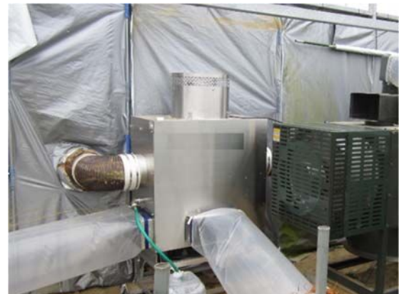
排熱回収装置
