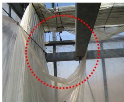
温室のコーナー部の隙間
