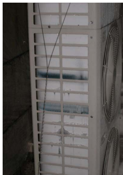
霜が付着した室外機
