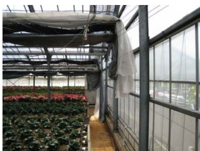
妻面のカーテンの隙間
