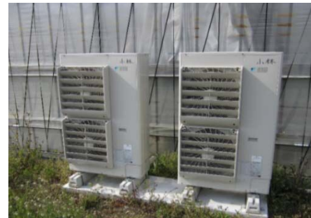
風向ガイドを取り付けた室外機
