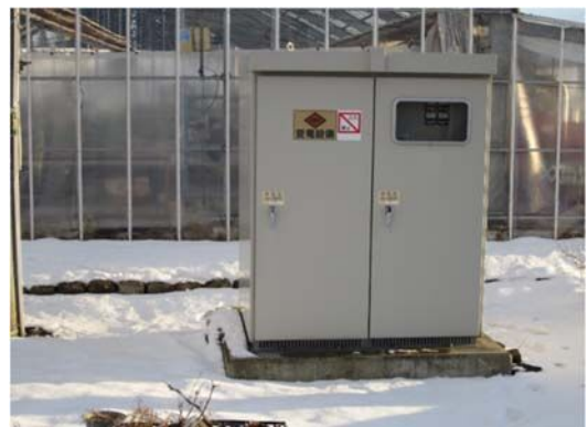
高圧受電設備（キュービクル）
