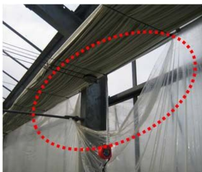
肩部の垂れ下がりによる隙間
