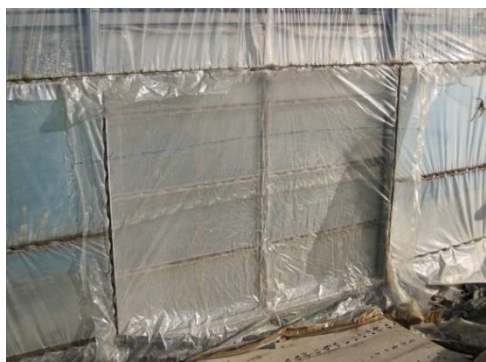
使用しない出入口を目張り
