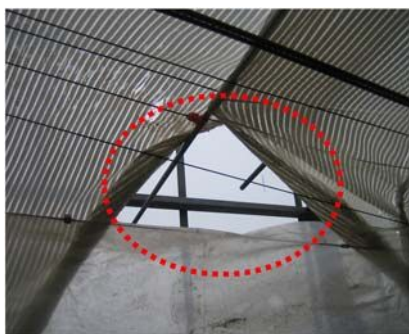
天井カーテンの隙間（妻面）
