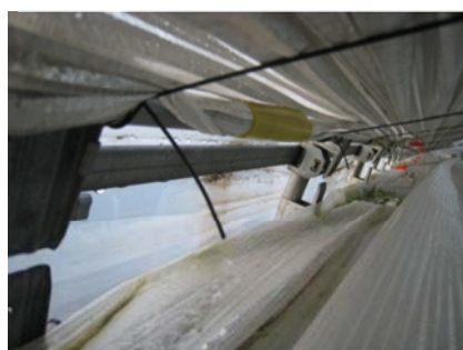
多層カーテン肩部の隙間
