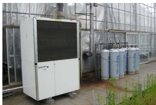
ガスヒートポンプ（室外機）
