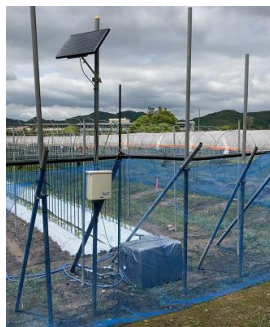
電源用ソーラーパネルと基盤
