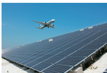
岡山空港太陽光発電所
