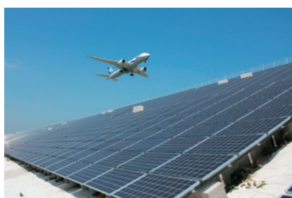
岡山空港太陽光発電所
